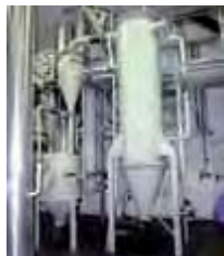
Impianto di gassificazione
